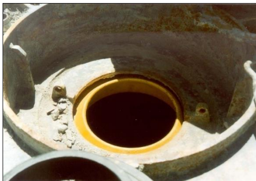
Araña descentrada sobre el anillo del tubo.
