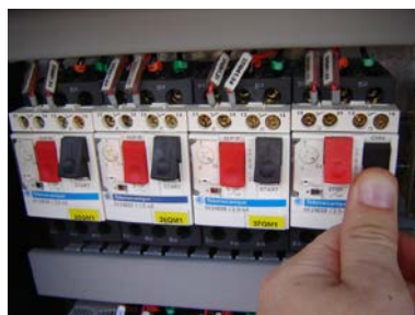
Fig. 26: Disjuntores / Disyuntores / Circuit breakers / Disjoncteurs
