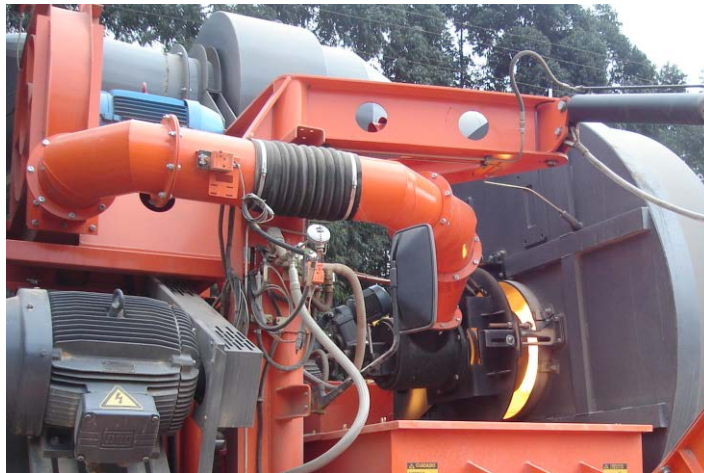
Fig. 2: Quemador en funcionamiento / Brûleur en fonctionnement
