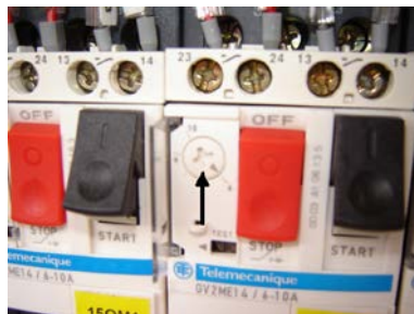
Fig. 5: Disjuntores / Disyuntores / Circuit breakers / Disjoncteurs
