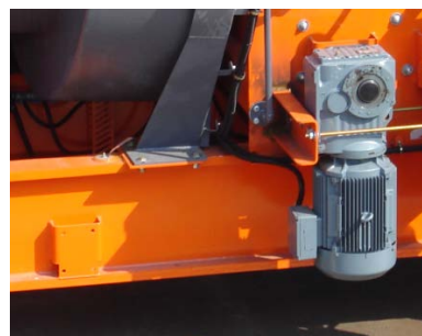
Fig. 12: Punto de medición próximo al filtro de mangas / Point de mesure près du filtre à manches
