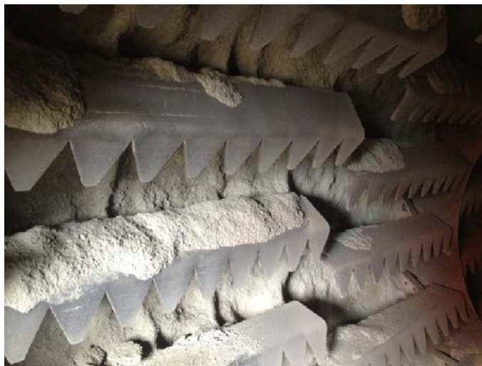
Fig. 25: Aletas do secador de agregados obstruídas / Aletas del secador de áridos obstruídas / Obstructed aggregate dryer blades / Ailettes du sécheur d'agrégats obstruées
