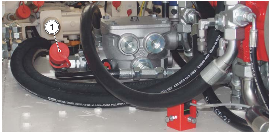
Figura IV - 9: Conexión llenado del depósito
