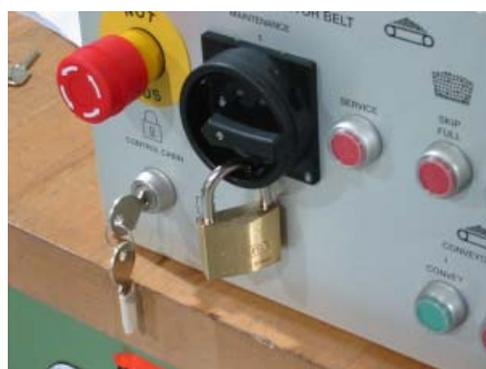
Figura III - 3: Interruptor de mantenimiento con candado
