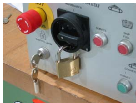
Figura VI - 1: Interruptor de mantenimiento con candado
