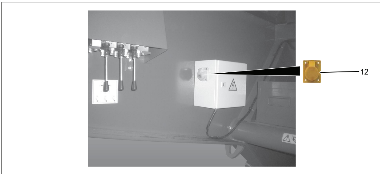
Abb. 2.63: Cajas de enchufe en el armario eléctrico
