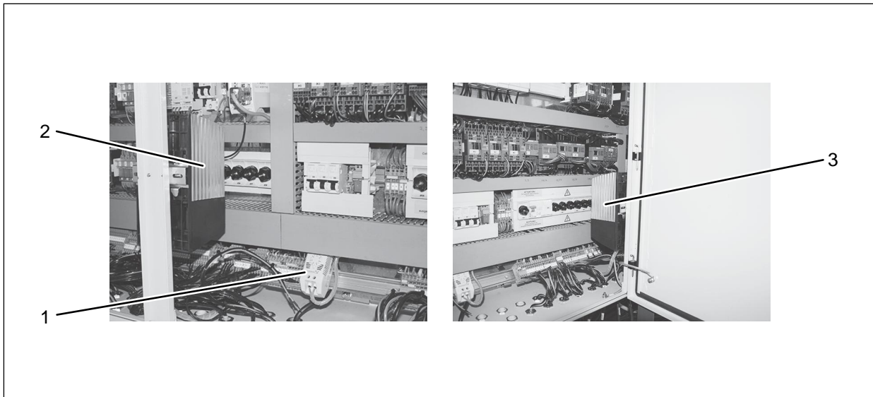
Abb. 3.10: Calefacción del armario eléctrico
