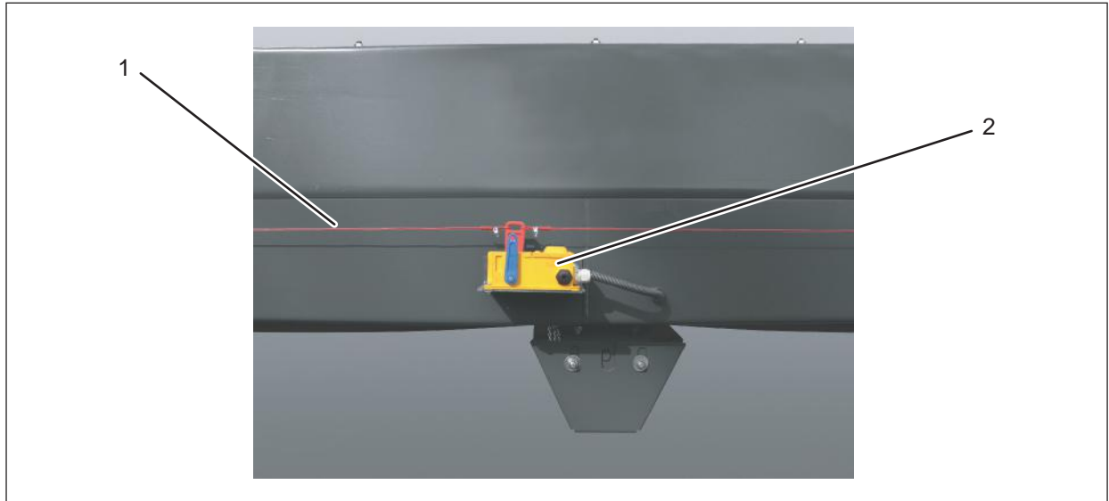
Abb. 2.15: Dispositivos de parada de emergencia situados en las cintas transportadoras
