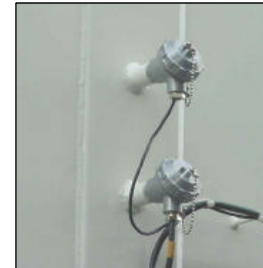
Sensor PT-100, localizado na parede lateral do filtro
