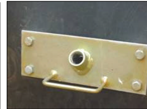
Sensor PT-100, localizado na calha de descarga de material do secador
