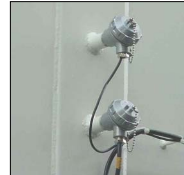
Sensor PT-100, localizado en la pared lateral del filtro
