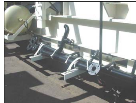
Tuberías para los rectificadores
