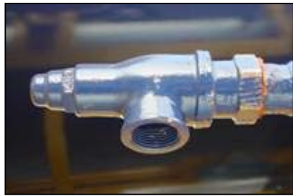
Salida inferior de la válv. de seguridad.
