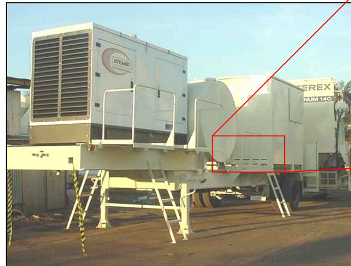
Chassi independente con cabina, generador e depósito diesel.
