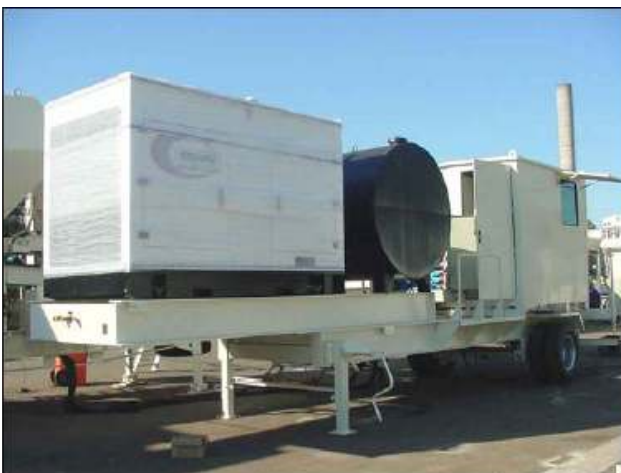
Cabine avulsa com gerador próprio
