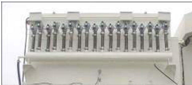
Reservatório suplementar – Usina Magnum 80
