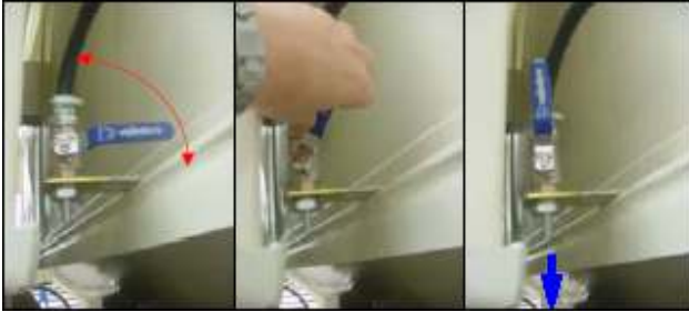
Válvula drenaje tanque pulmón filtro de mangas
