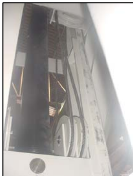
C2 – Cilindro hidráulico tensionador dos cabos (E) Hydraulic cylinder for the pulling four cables
