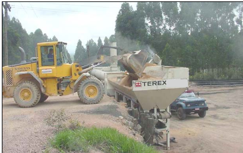
Descarregamento adequado de material no silo. Correct loading in the silo
