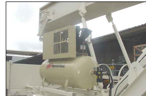
Compressor do silo de armazenamento Compressor del silo de almacenaje Stocking silo compressor
