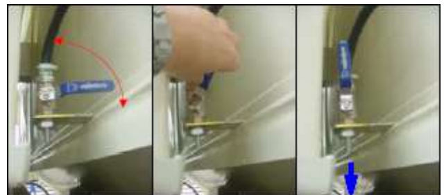
Válvula drenaje tanque pulmón filtro de mangas
