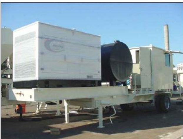
Cabine avulsa com gerador próprio
