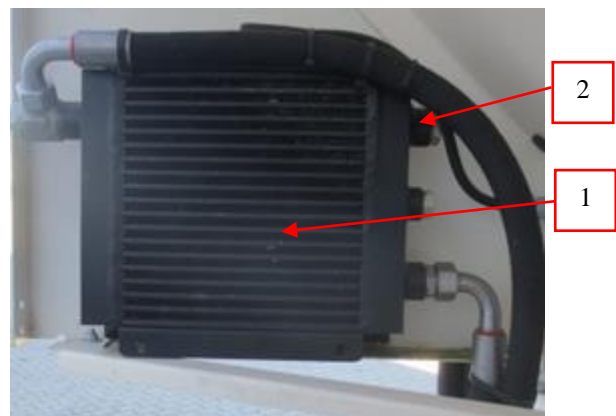
Fig. 4-34 Refrigerador de aceite hidráulico
