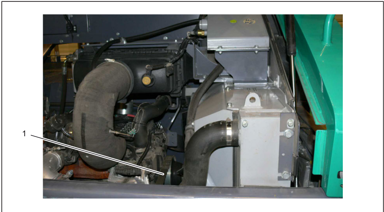
Ábra 4-7: A hajtósíj ellenőrzése
