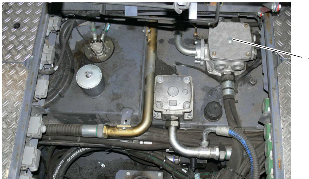
Att. 4-21: Hidrauliskās eļļas tvertne
