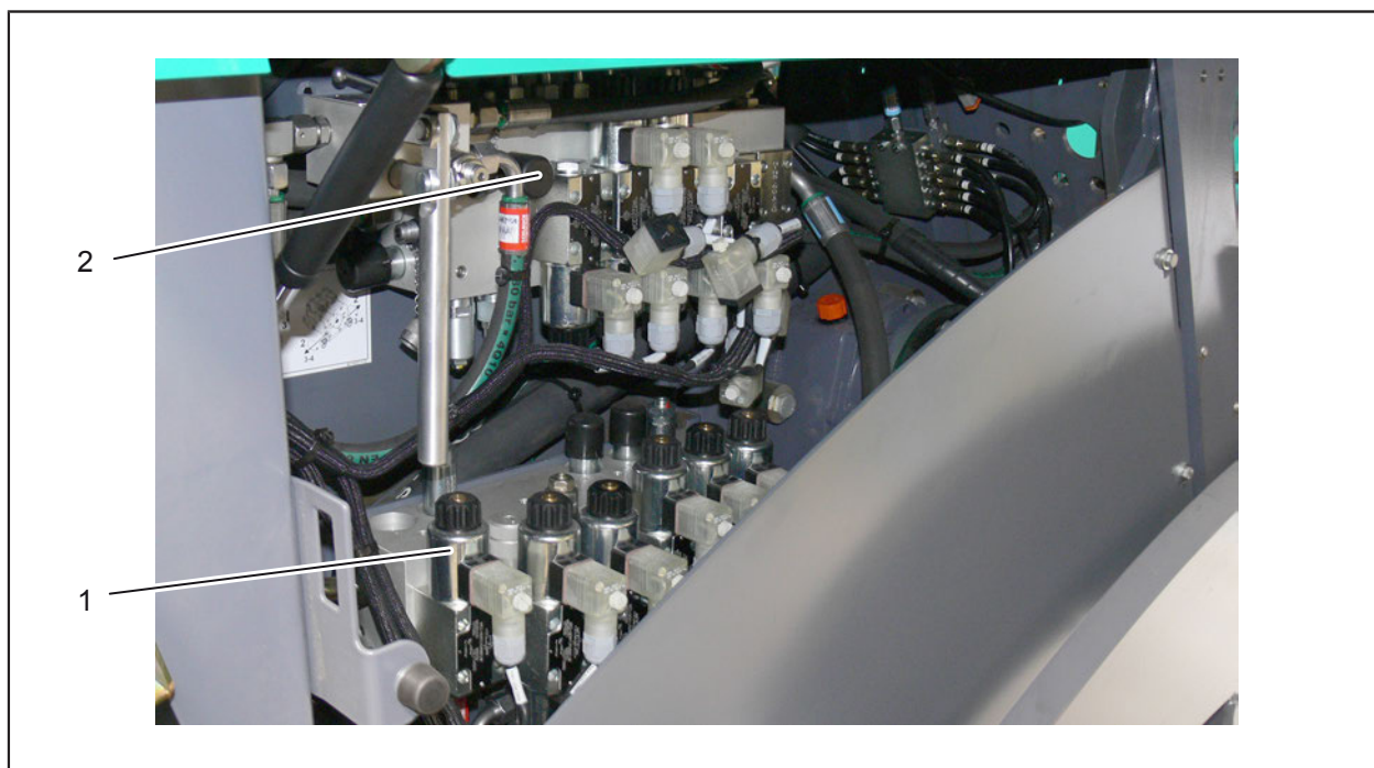
Fig. 2-85: Blocuri de comandă (I)
