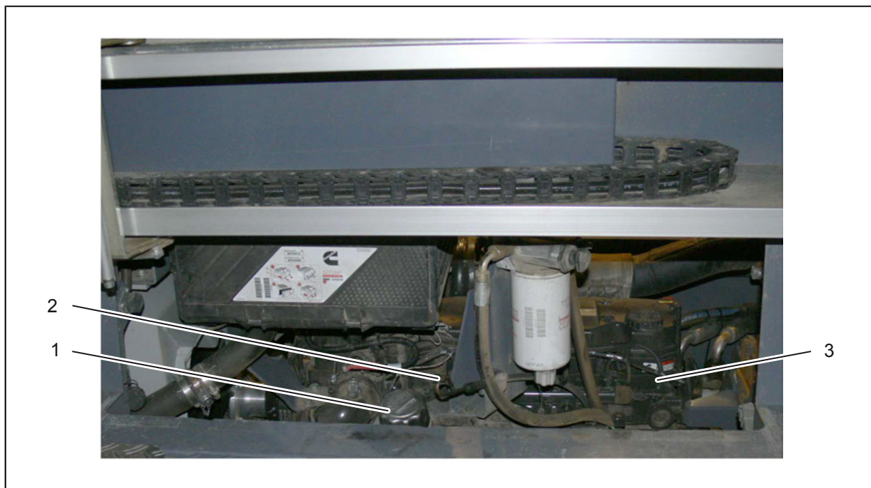
Fig. 2-72: Stație motor (I)
